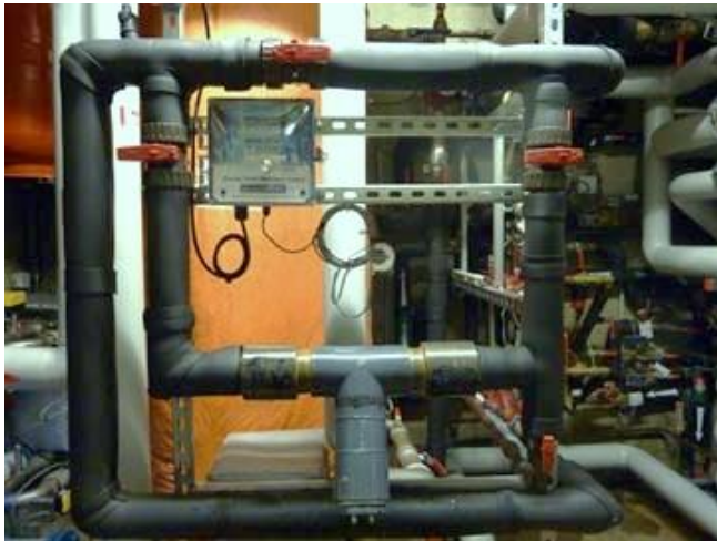
Ionisateur monté sur réseau ECS
